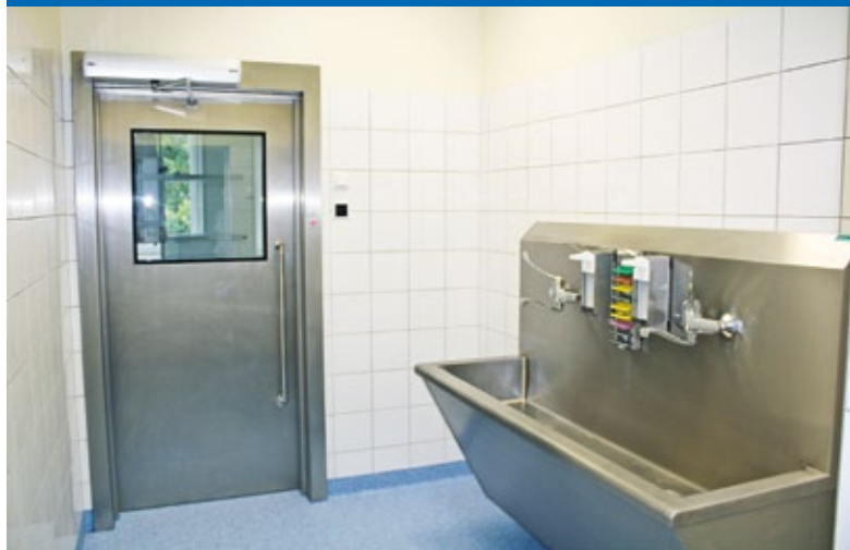
Myjnia chirurgiczna dla lekarzy przed salą operacyjną. Wyposażona jest w nierdzewne urządzenie zlewowe wraz z dezynfektorami. Drzwi do sali operacyjnej wykonane są z blachy nierdzewnej, kwasoodpornej i otwierane są w systemie bezdotykowym na fotokomórkę
