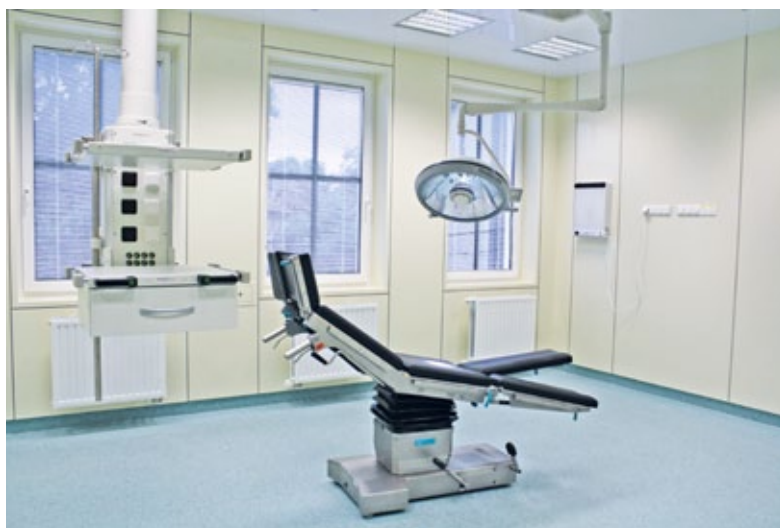
Sala operacyjna. Ściany wykonane są z paneli z blachy nierdzewnej pomalowanej proszkową farbą zawierającą bakteriobójcze jony srebra. Panele połączone są hermetycznymi uszczelkami. Sufit panelowy z blachy nierdzewnej malowanej proszkową bakteriobójczą farbą z jonami srebra na hermetycznych uszczelkach. Podłoga pokryta antystatyczną i bakteriobójczą wykładziną. Okna z PCV z międzyszybowymi żaluzjami. Sala wyposażona jest w indywidualną wentylację mechaniczną z klimatyzacją wytwarzającą nadciśnienie wykluczające możliwość mieszania się powietrza z innych części szpitala. Realizowane jest to przez sufitowe laminarne systemy nawiewne z filtrami absolutnymi. Do sali doprowadzone są gazy medyczne: tlen, próżnia, powietrze i podtlenek azotu. Sala wyposażona jest w najnowocześniejszy stół operacyjny PRELUDIUM, negatoskop ścienny, anesteziologiczną kolumnę sufitową z napędem powietrznym oraz sufitową, wieloramienną lampę operacyjną
