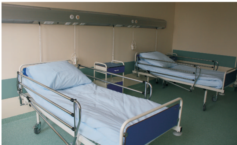
Oddział Ginekologiczny. Sala 2-osobowa z łazienką, nad łóżkami panel z gazami medycznymi, z oświetleniem dziennym i nocnym oraz instalacją przyzywową. Każdy pokój ma dostęp do wewnętrznej sieci komputerowej połączonej światłowodami.
