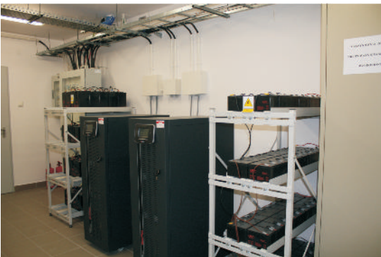
Główna rozdzielnia elektryczna wraz z UPS-ami i dodatkowymi akumulatorami gwarantują 24-godzinne utrzymanie szpitalnych urządzeń elektrycznych. W pomieszczeniu znajduje się również maszynownia windy. Podwojenie tych urządzeń ma na celu zapewnienie funkcjonowania w przypadku awarii jednego z nich. Do pomieszczenia doprowadzona jest również instalacja komputerowa ze wszystkich pomieszczeń nowego budynku szpitala i podłączona do centralnej serwerowni. Pomieszczenie to jest klimatyzowane indywidualnym klimatyzatorem.
