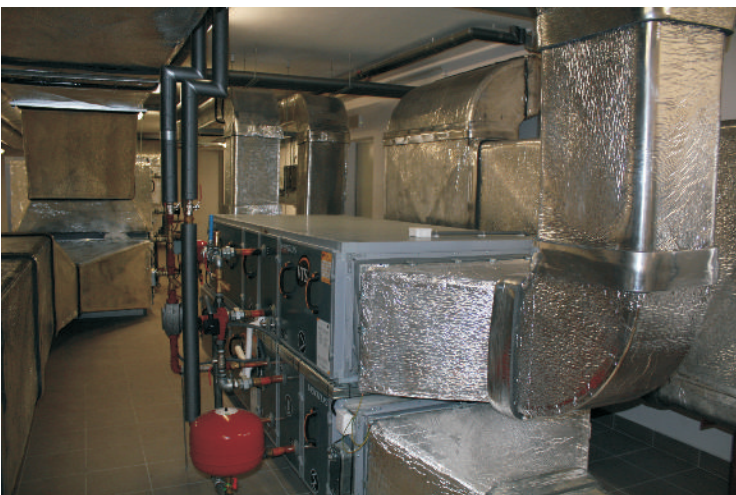
Stacja wentylacji mechanicznej obsługująca kondygnacje budynku szpitala. Wyposażona jest w system odzysku ciepła poprzez wymienniki. Powietrze jest podgrzewane, chłodzone i filtrowane przez system filtrów.
