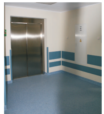
Hol z windą na Oddziale Noworodkowo – Położniczym. Winda wykonana w technologii blachy nierdzewnej z napędem hydraulicznym.
