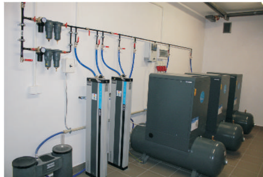
Pomieszczenie techniczne, w którym znajduje się instalacja sprężonego powietrza z 4 urządzeniami do osuszania oraz z filtrami. Trzy niezależne sprężarki zapewniają bezpieczeństwo w przypadku awarii jednego z tych urządzeń lub zwiększonego zapotrzebowania.
