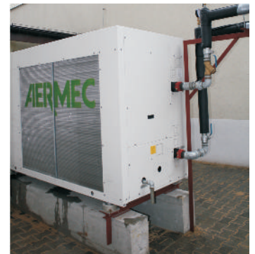
Agregat klimatyzacyjny wody lodowej służący do klimatyzowania traktu porodowego. Znajduje się on w patio pomiędzy starym a nowym budynkiem szpitala.
