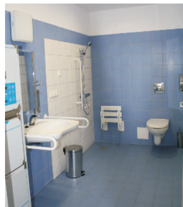
Łazienka w izolatce na Oddziale Położniczym wyposażona w sprzęt i osprzęt dla osób niepełnosprawnych oraz w automatyczne urządzenie dezynfekujące do nocników, kaczek i basenów.
