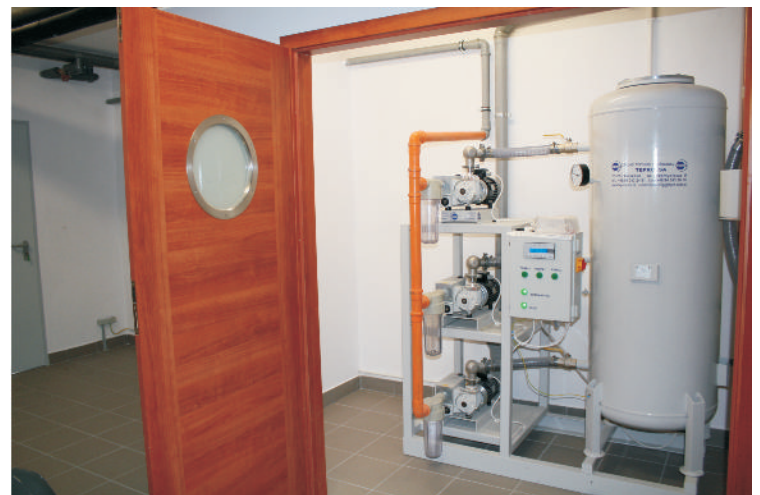
Pomieszczenie techniczne wyposażone w 3 pompy do wytwarzania próżni w systemie zapewniającym bezpieczeństwo w sytuacji zwiększonego poboru lub awarii.
