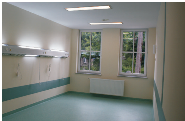
Oddział Pediatryczny, sala dzieci młodszych wyposażona w panel z gazami medycznymi, instalację oświetlenia dziennego i nocnego oraz w instalację przyzywową. Sala wentylowana jest poprzez mechaniczną wentylację nawiewno – wyciewną.
