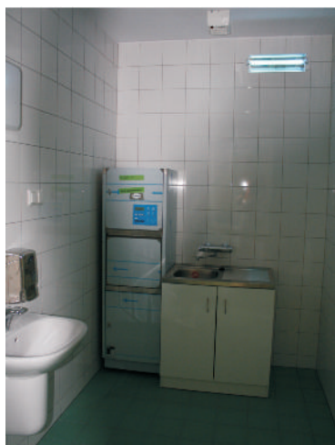
Brudownik wyposażony m.in. w automatyczne urządzenie dezynfekujące do nocników, kaczek i basenów (po lewej stronie) i lampę bakteriobójczą z licznikiem pracy.
