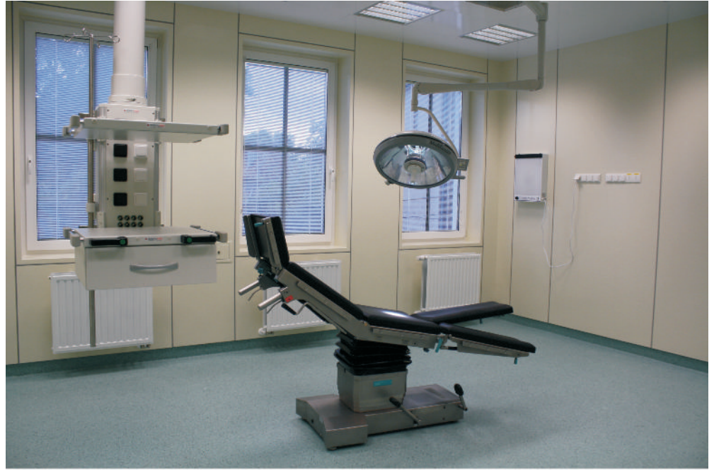
Sala operacyjna. Ściany wykonane są z paneli z blachy nierdzewnej pomalowanej proszkowo farbą zawierającą bakteriobójcze jony srebra. Panele połączone są hermetycznymi uszczelkami. Sufit panelowy z blachy nierdzewnej malowanej proszkowo bakteriobójczą farbą z jonami srebra na hermetycznych uszczelkach. Podłoga pokryta antystatyczną i bakteriobójczą wykładziną. Okna z PCV z międzyszybowymi żaluzjami. Sala wyposażona jest w indywidualną wentylację mechaniczną z klimatyzacją wytwarzającą nadciśnienie wykluczające możliwość mieszania się powietrza z innych części szpitala. Realizowane jest to przez sufitowe laminarne systemy nawiewne z filtrami absolutnymi. Do sali doprowadzone są gazy medyczne: tlen, próżnia, powietrze i podtlenek azotu. Sala wyposażona jest w najnowocześniejszy stół operacyjny PRELUDIUM, negatoskop ścienny, anestetyczną kolumnę sufitową z napędem powietrznym oraz sufitową, wieloramienną lampę operacyjną.
