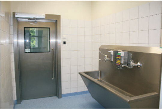
Myjnia chirurgiczna dla lekarzy przed salą operacyjną. Wyposażona jest w nierdzewne urządzenia zlewowe wraz z dezynfektorami. Drzwi do sali operacyjnej wykonane są z blachy nierdzewnej, kwasoodpornej i otwierane są w systemie bezdotykowym na fotokomórkę.
