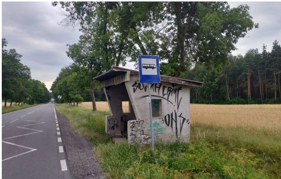
Rys. 25. Stara i zaniedbana wiata autobusowa na przystanku w Irkach. Opracowanie własne.
